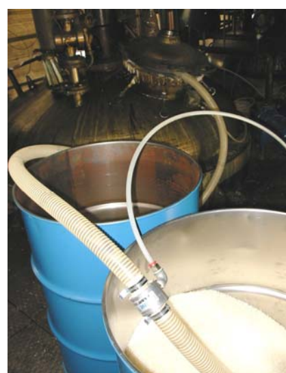
Line Vac 6082 convoglia granuli di colla nella caldaia di fusione
