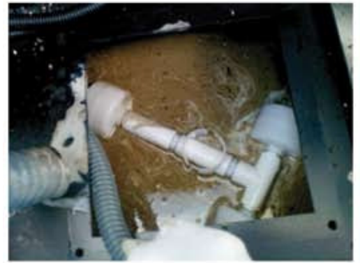
Pescante galleggiante in vasca prima della depurazione
