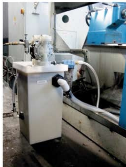
Depuratore - disoleatore MIXI in funzione
